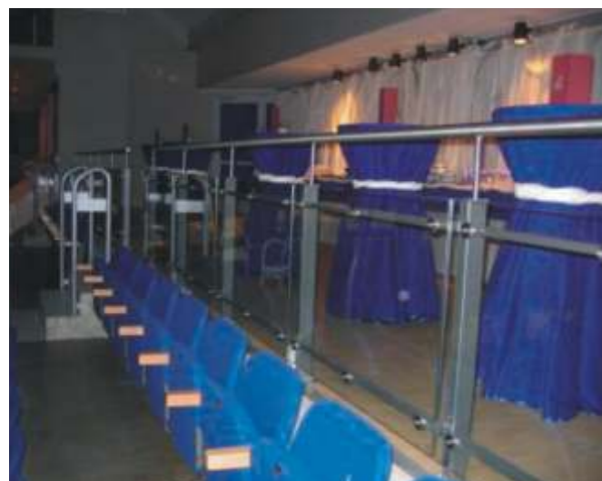
Saku Suurhall Klaaspiirded Saku Arena Glass guard-rail
